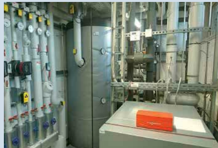
Abb. 59: Die Haustechnikzentrale Foto: Stadt Feuchtwangen
