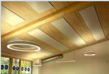
Abb.70: Integrierte Deckenheizung, LED-Leuchten Foto: Haase & Bey Architekten
