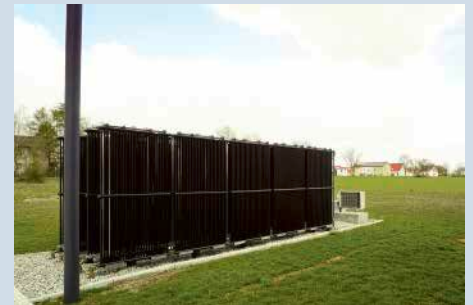
Abb. 60: Der Solar-Luftabsorberblock Foto: Stadt Feuchtwangen
