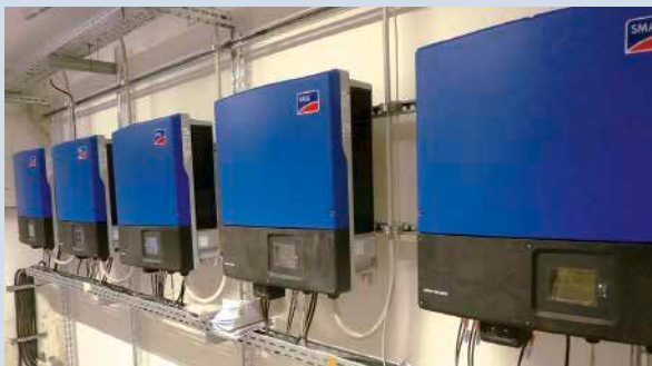
Abb. 93: Elektrische Wechselrichter mit Leistungsanzeige Foto: Fraunhofer IBP
