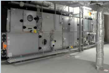
Abb. 34: Die zentrale Lüftungsanlage Foto: COPLAN AG
