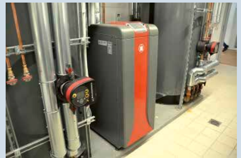
Abb. 72: Wärmepumpe und Schichtenspeicher Foto: Haase & Bey Architekten
