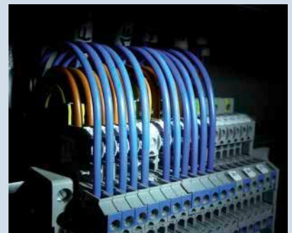
Abb. 95: Messserver Foto: Fraunhofer IBP
