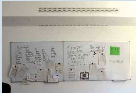
Abb. 24: Deckenauslässe der Lüftungsanlage Foto: Gymnasium Neutraubling
