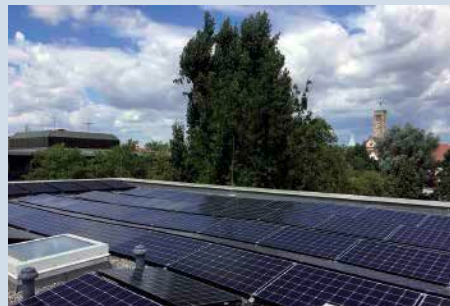
Abb. 12: Die Photovoltaik-Anlage Foto: Rhein-Neckar-Kreis
