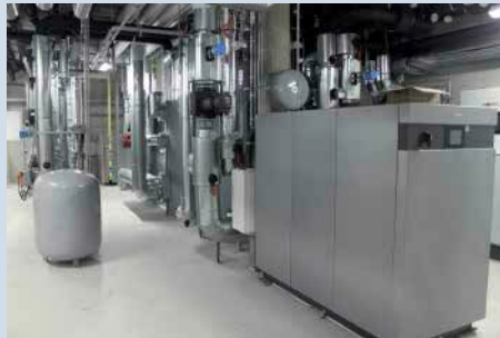
Abb. 35: Die Wärmepumpe im Technikraum Foto: COPLAN AG
