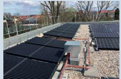
Abb. 13: Die Solarthermie-Anlage Foto: Ingenieurbüro Willhaug
