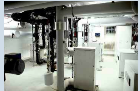
Abb. 25: Blick in die Technikzentrale Foto: Gymnasium Neutraubling
