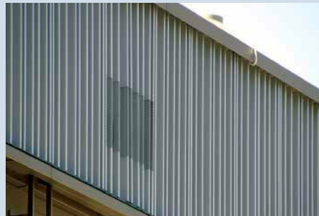
Abb. 47: Fassadendetail der Luftein-/auslässe Foto: Stadt Kaufbeuren
