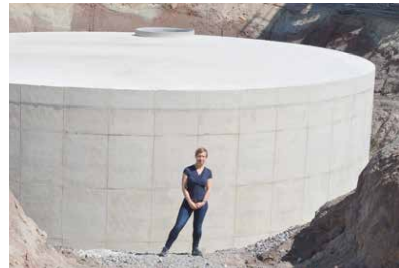
Mittlerweile nicht mehr sichtbar: Der Eisspeicher im Untergrund (Foto: Jens Renner)
