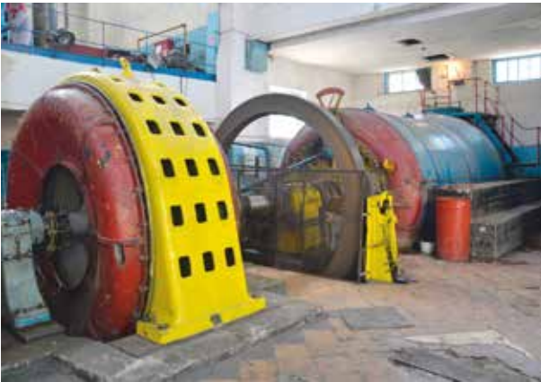
Blick in eine Turbinenhalle im laufenden Betrieb (Foto: Tom Wolfertstetter)
